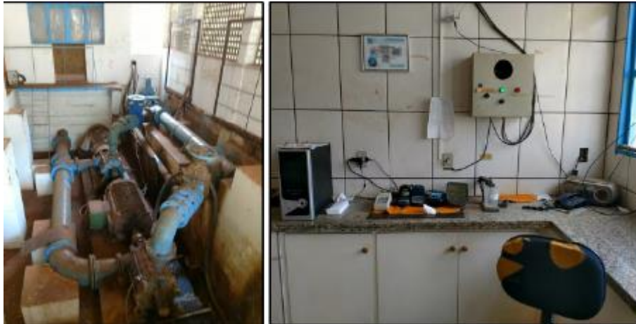
Figura 5 - Elevatória de Água Tratada e Laboratório
