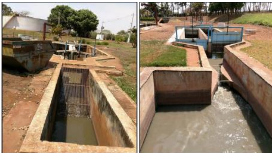
Figura 10 – Gradeamento Grosso, Desarenador e Medidor Parshall
