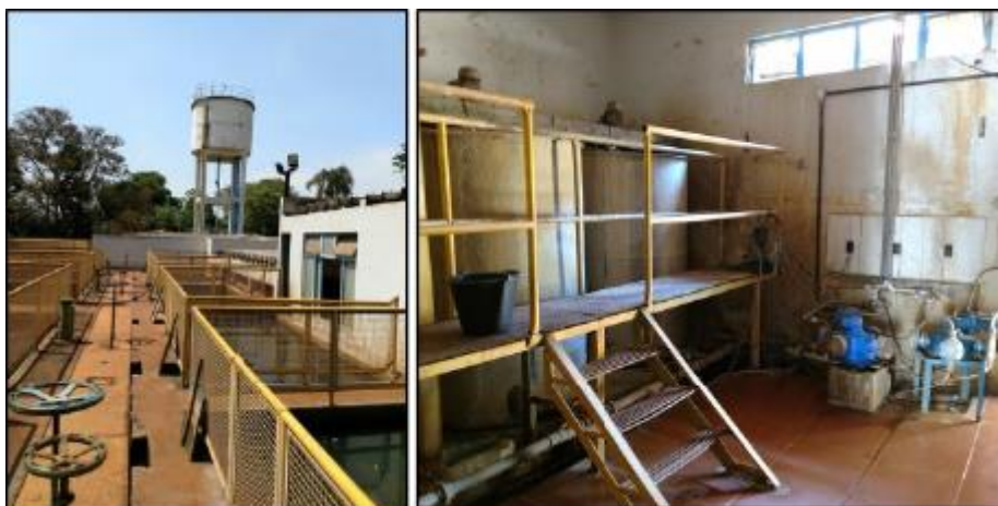
Figura 4 - Filtros, Reservatório Elevado e Tanque de Preparo de Produtos Químicos
