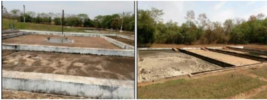
Figura 12 - Reator SANEVIX e Desinfecção Ultravioleta
