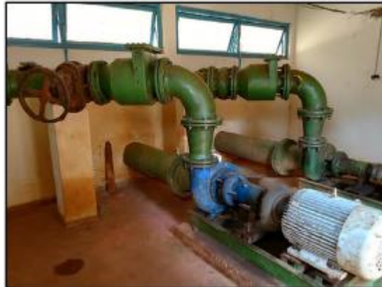
Figura 2 - Conjunto Motobomba da EAB
