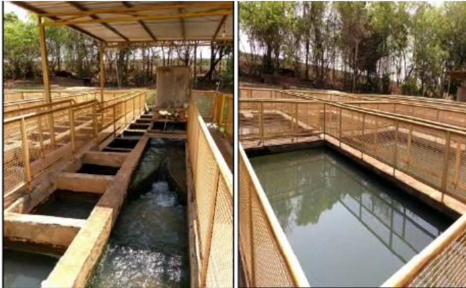
Figura 3 - Medidor Parshal, Floculador e Decantadores
